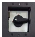
BYPASS DE MANTENIMIENTO
